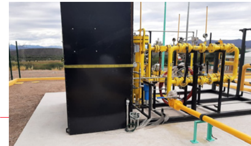
Recambio de combustible en Molymex (Gas licuado de petróleo por gas natural)
