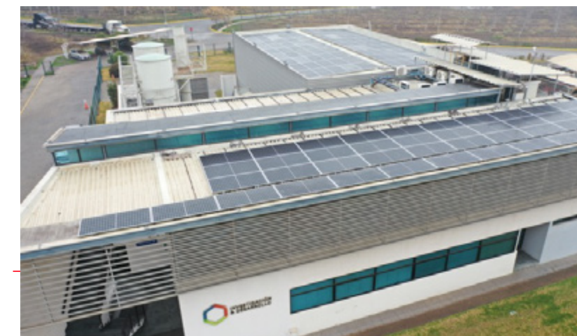
Sistema fotovoltaico Edificio I+D
